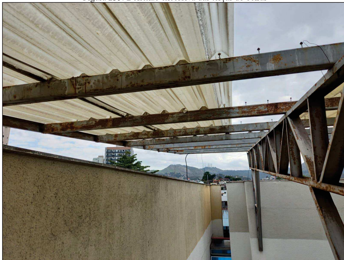
Figura 235: Deflexão excessiva das terças do beiral
