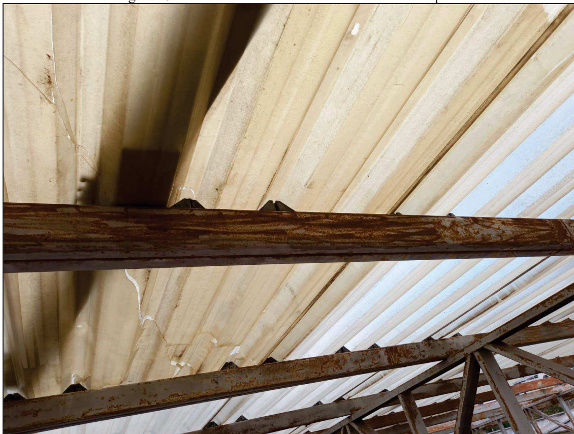
Figura 19: Telhas danificadas deixando a estrutura exposta
