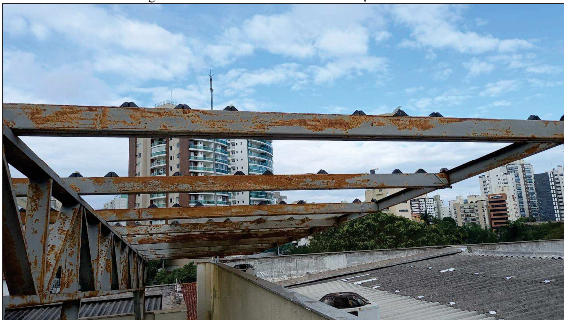
Figura 26: Deflexão excessivas das terças do beiral
