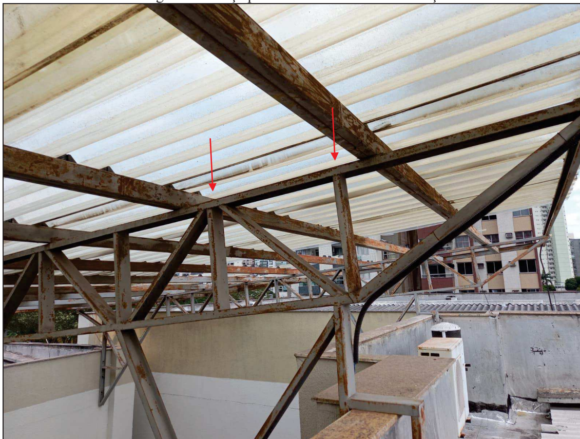
Figura 20: Terça posicionada fora do nó da treliça
