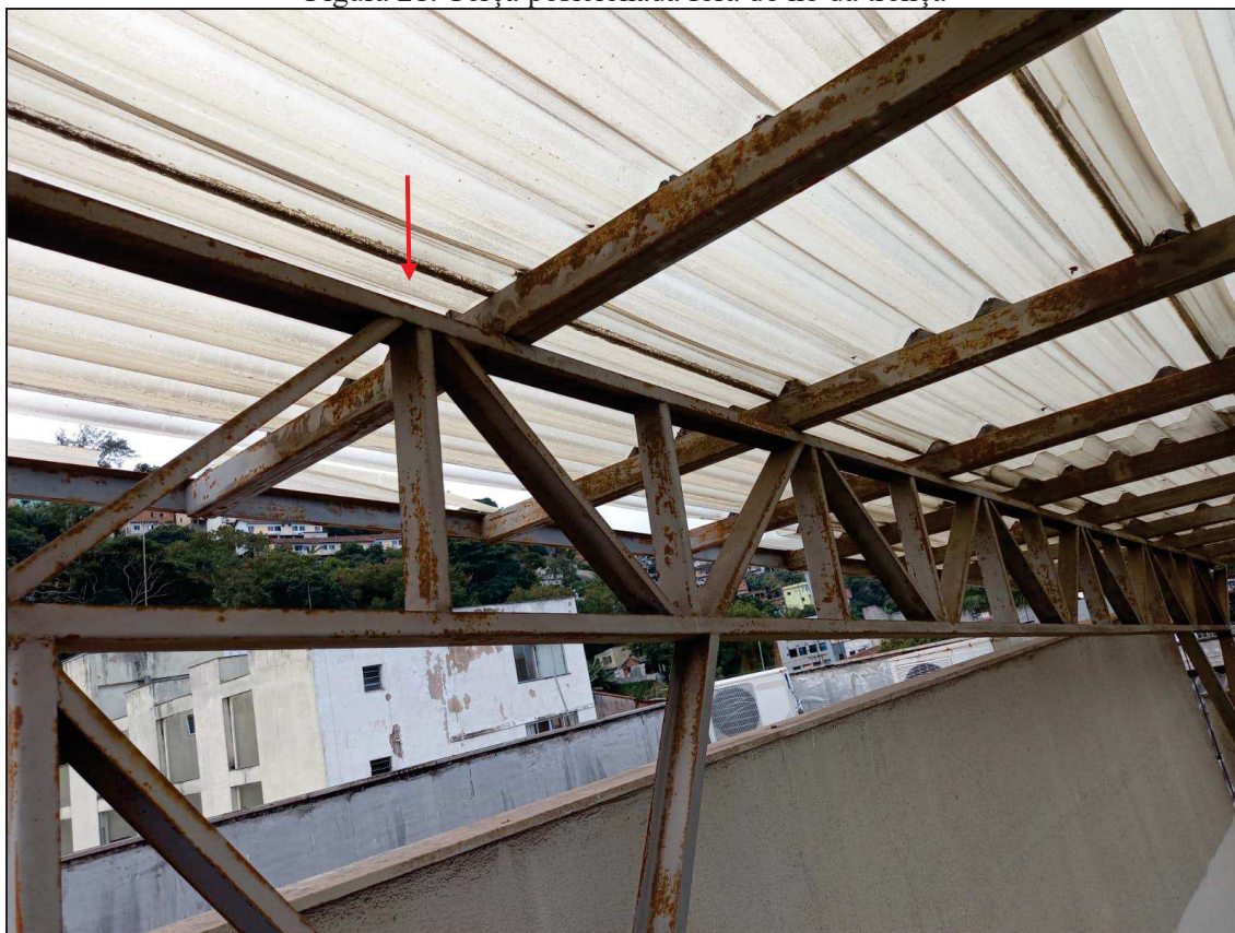
Figura 21: Terça posicionada fora do nó da treliça
