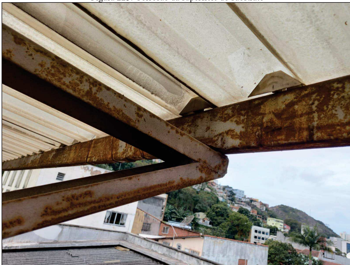
Figura 223: Corrosão da superfície do substrato
