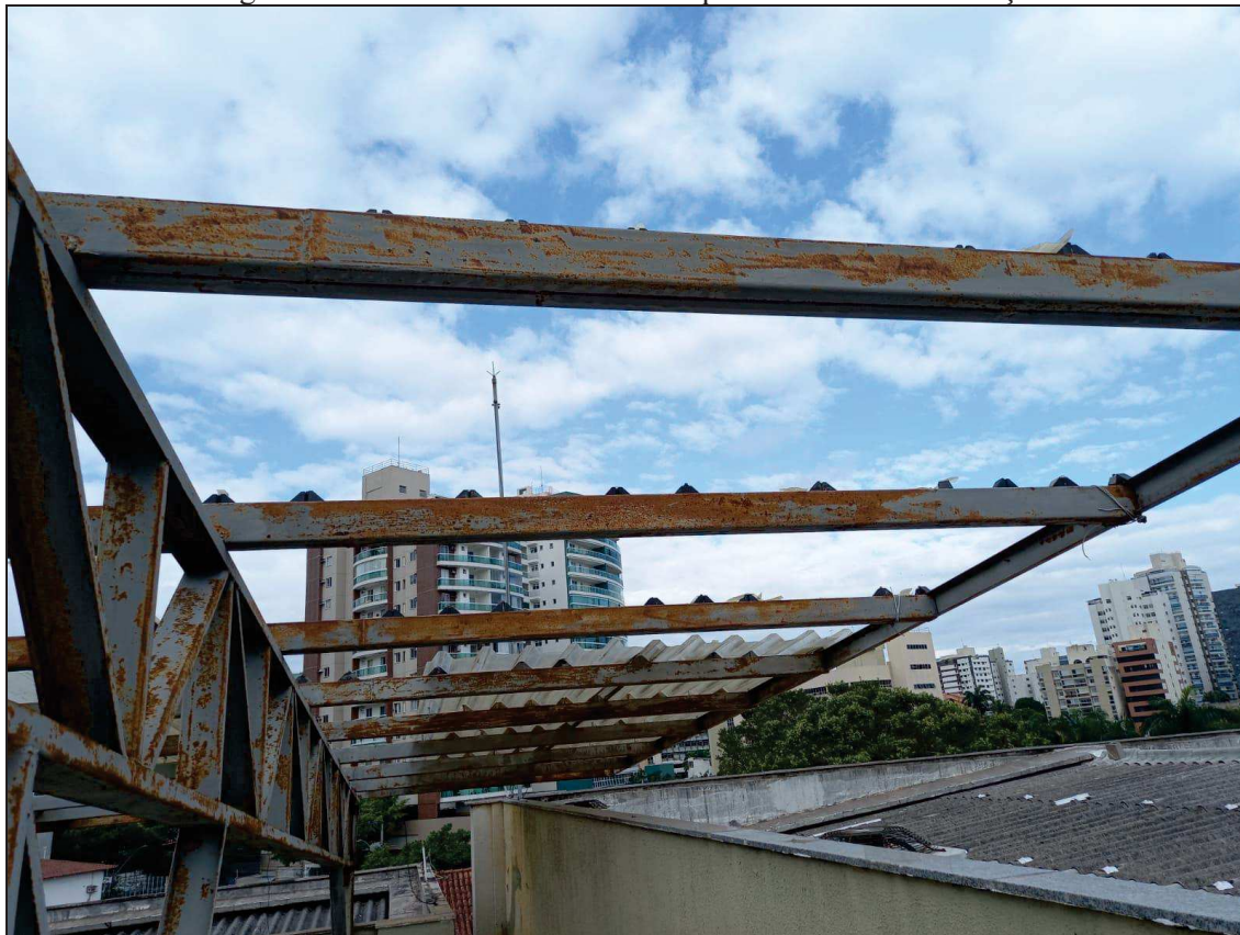
Figura 17: Ausência de mão-francesa para travamento das terças
