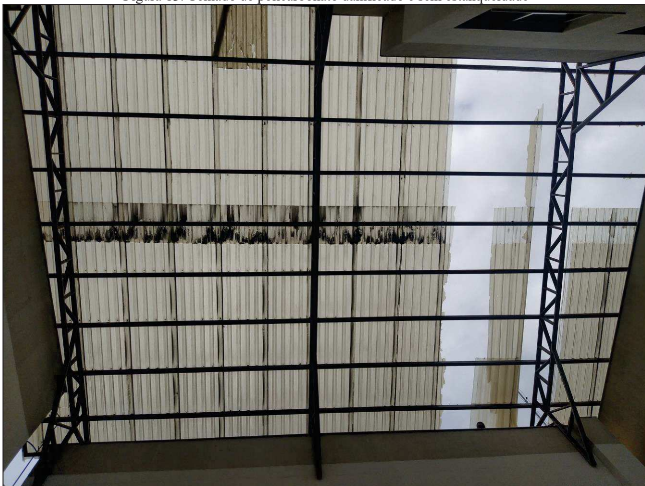
Figura 13: Telhado de polycarbonato danificado e sem estanqueidade
