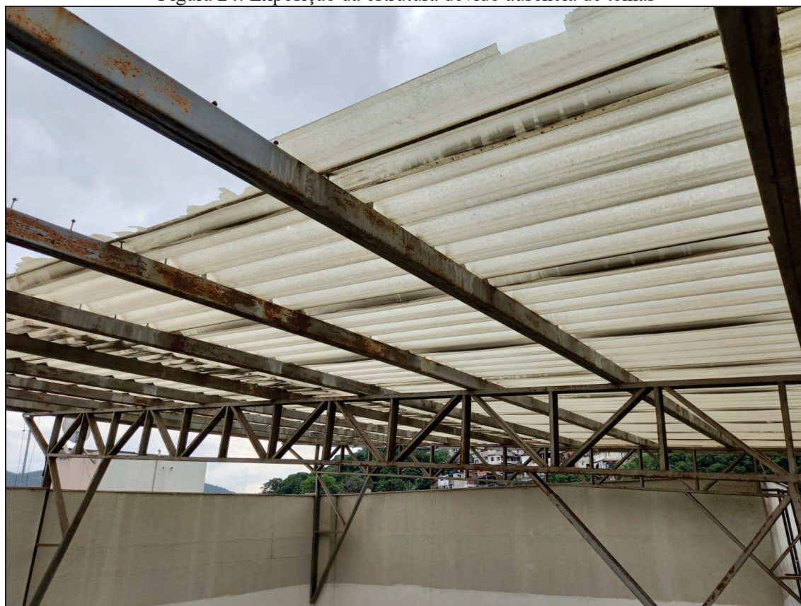
Figura 24: Exposição da estrutura devido ausência de telhas
