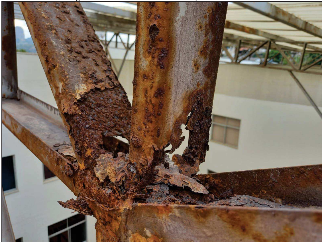
Figura 15: Processo de corrosão avançado do nó da TR1
