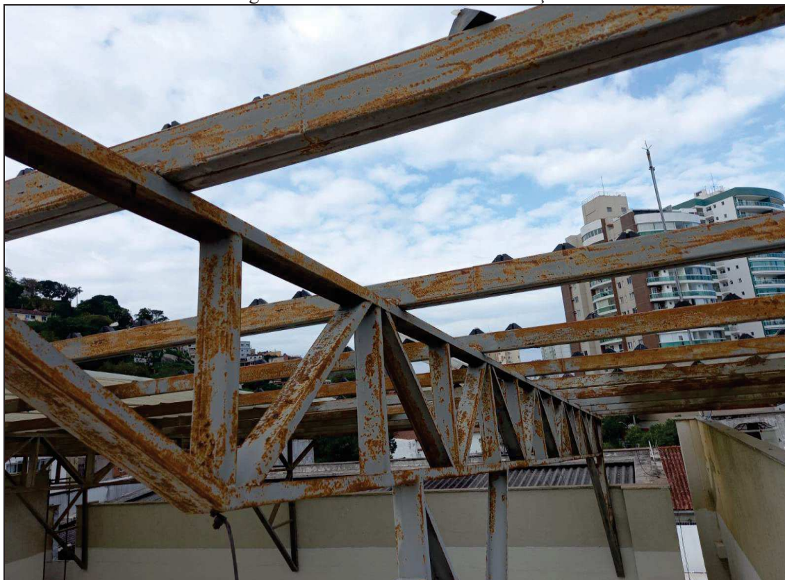
Figura 18: Ausência de tirante nas terças
