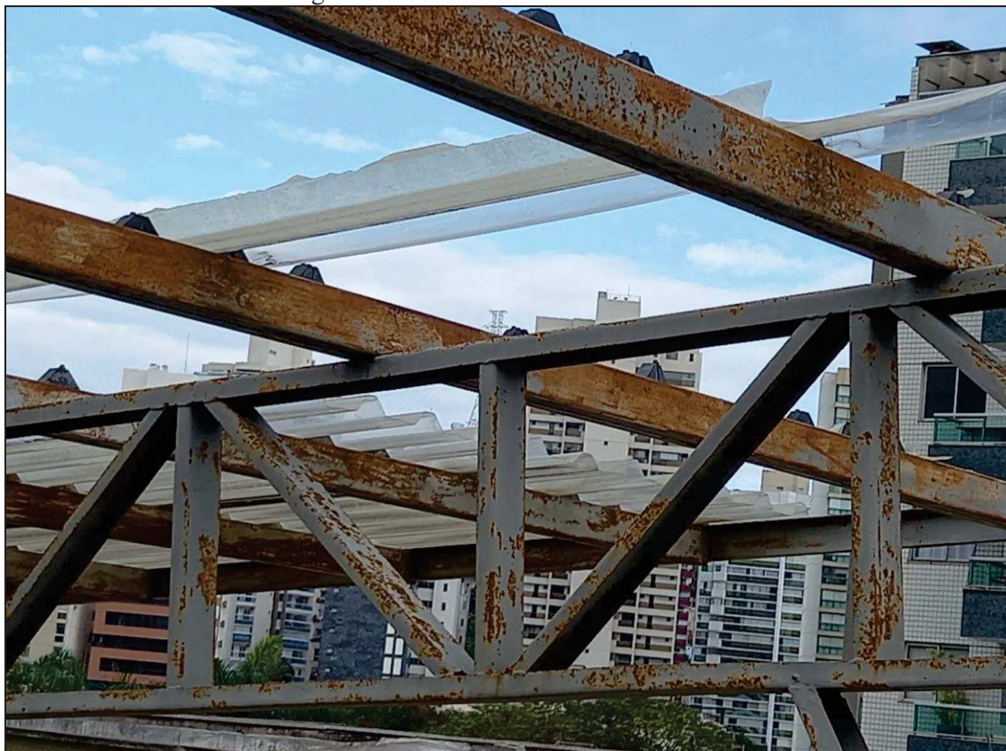
Figura 16: Corrosão na estrutura metálica
